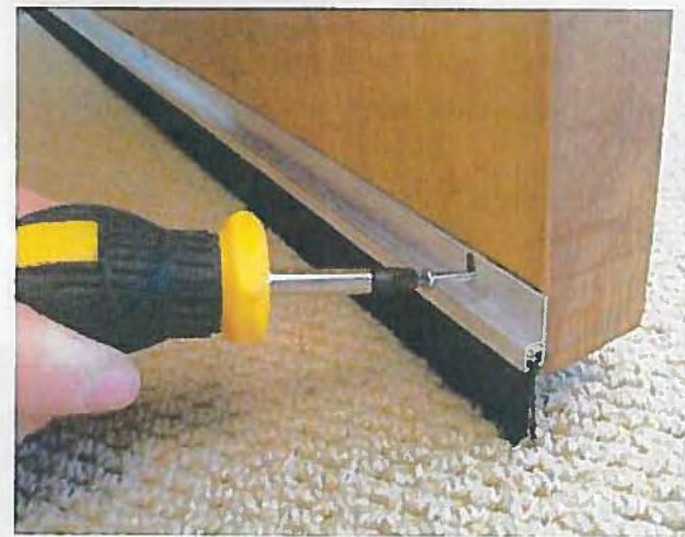
Fig 4 Installazione di spazzole per la prevenzione delle intrusioni di infestanti.
