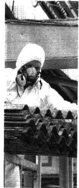
SMALTIMENTO La sostituzione di coperture in eternit deve essere fatta con la massima sicurezza possibile
