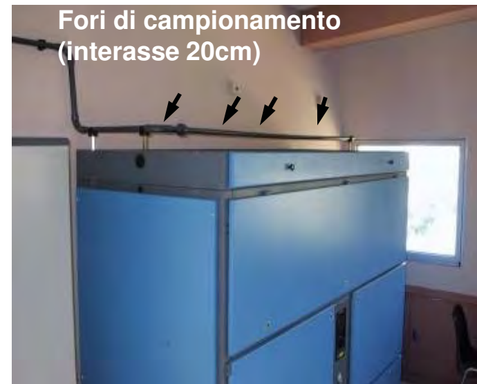
Dettaglio della tubazione
